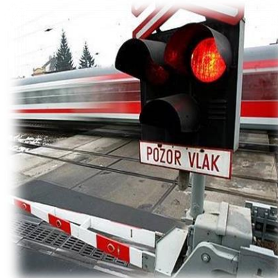
Off-grid železniční výstražná zařízení
