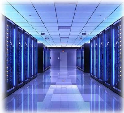
Kritická infrastruktura datacentra
